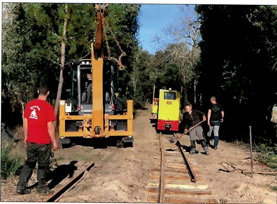
STTST - Les interminables travaux de voie, amplifiés par l'érosion marine.
